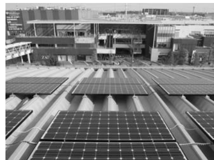
屋根上の太陽光発電設備
